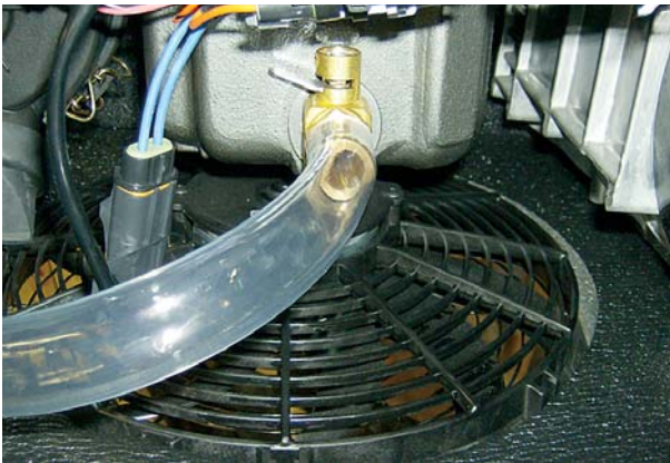
Lower Cabinet Fan
